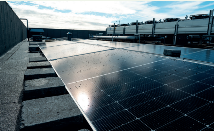
Utvendig tak er flatt og tekket. Der står fire tørrkjølere, mens det resterende ledige arealet er dekket av solceller. Foto: Skarp/Backe
